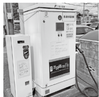
急速充電設備
