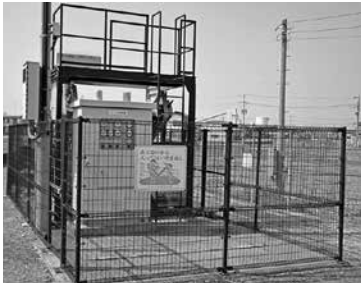
緑町排水機場
