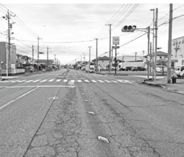
傷んだ舗装道路
