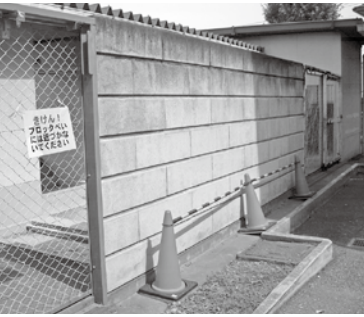
小学校プールブロック塀
