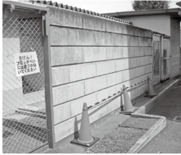
小学校プールブロック塀
