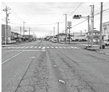
傷んだ舗装道路
