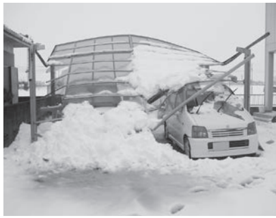
カーポートの倒壊
