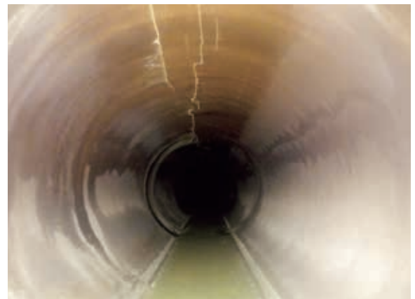
市内で見発見された老朽化した下水道管路の破損状況(管の上部)
