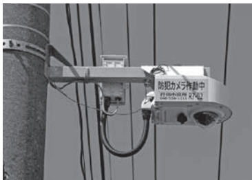
設置した防犯カメラ
