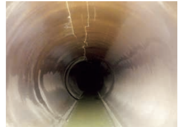
市内で発見された老朽化した下水道管路の破損状況(管の上部)
