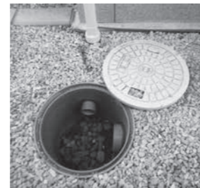
宅内浸透枳の例
