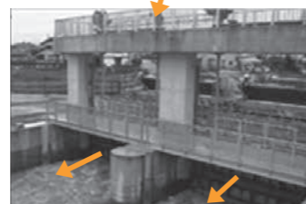
佐間水門の忍川からの取り込み状況
