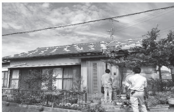
強風により屋根が損壊した家屋
