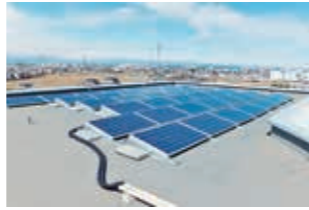
太陽光パネル
