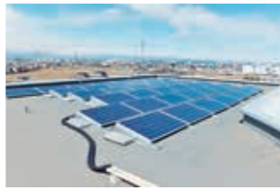
太陽光パネル
