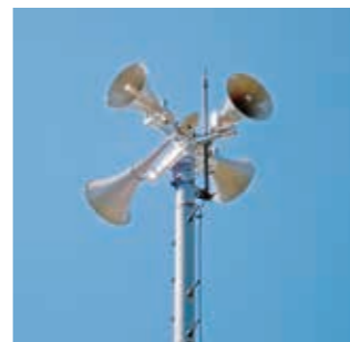
防災無線をデジタル方式に更新
