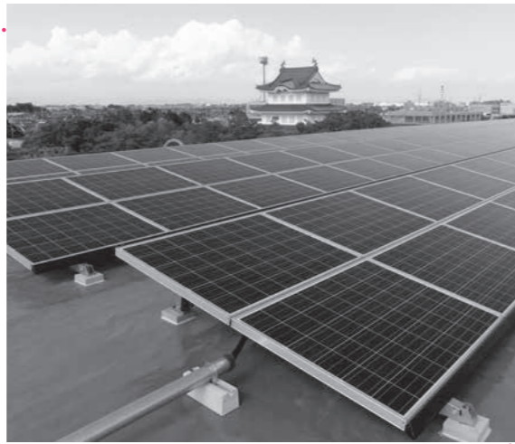
忍中学校屋上に設置された太陽光発電設備
