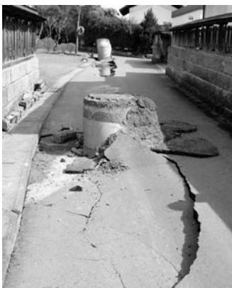
液状化により隆起した下水管
