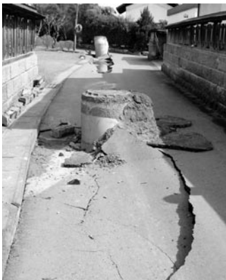
液状化により隆起した下水管
