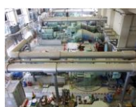
糠田排水機場ポンプ施設
