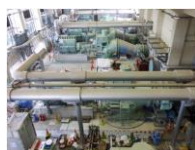
糠田排水機場ポンプ施設
