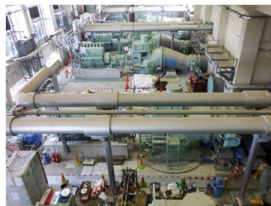
糠田排水機場ポンプ施設
