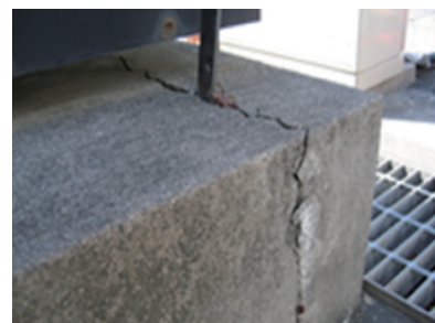
看板基礎のひび割れ
