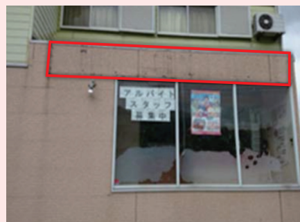
落下した後の壁面
