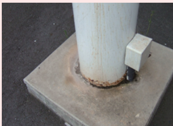
ポールの根元にサビが発生
