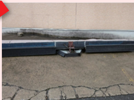
落下した欄間看板
