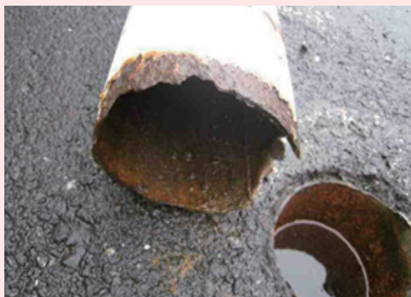
ポールの根腐れによる倒壊
