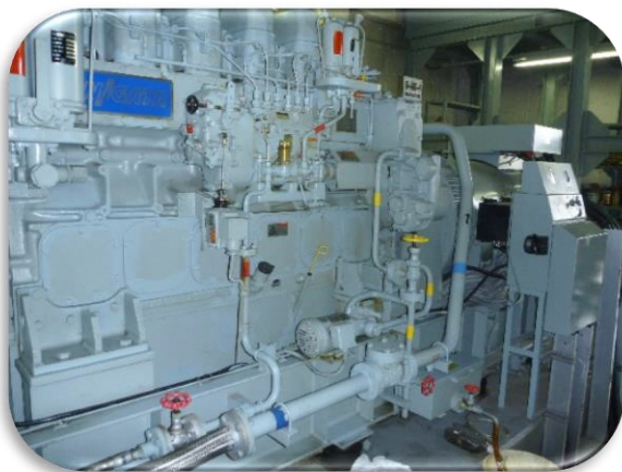
非常用発電機
