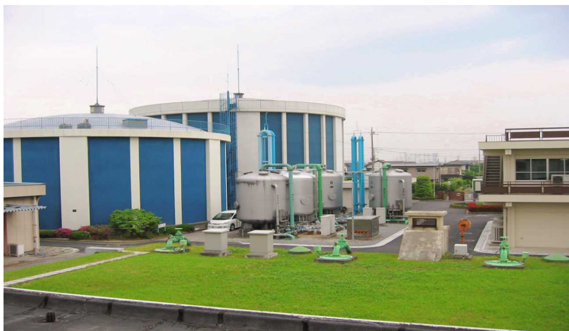
行田市向町浄水場(ろ過機・配水タンク等)
