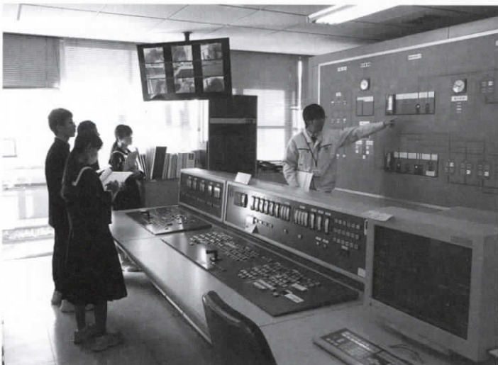
③施設を管理する中央操作室の「操作盤」(向町浄水場)
