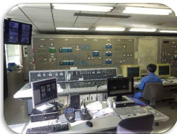
中央監視装置
