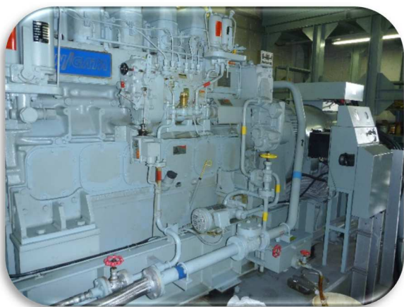
非常用発電機
