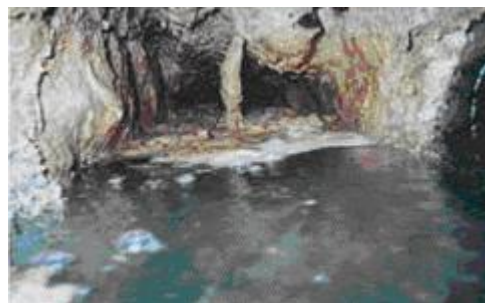
油が固まった下水道管
