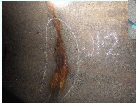
侵入水発生状況
