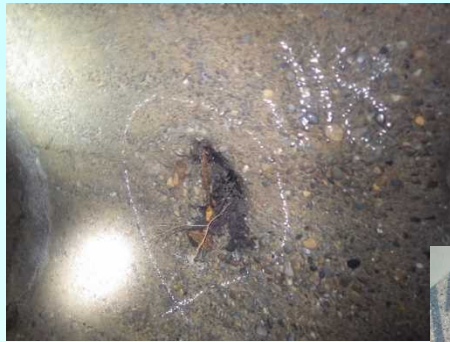
鉄筋露出状況
