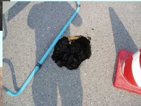
道路陥没状況
