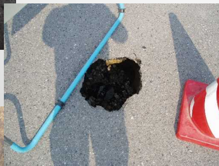
道路陥没状況
