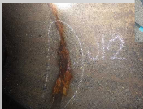
侵入水発生状況
