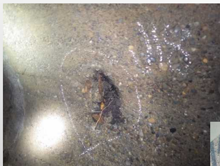
鉄筋露出状況
