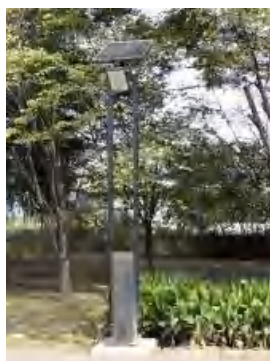
環境に配慮した照明灯
