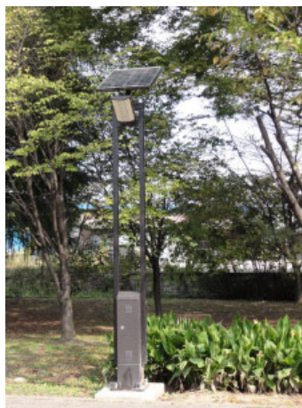
環境に配慮した照明灯
