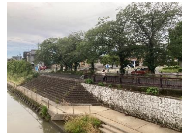
忍川 転落防止柵
