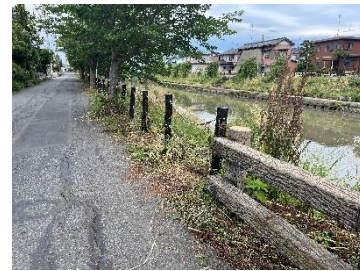
忍川 転落防止柵
