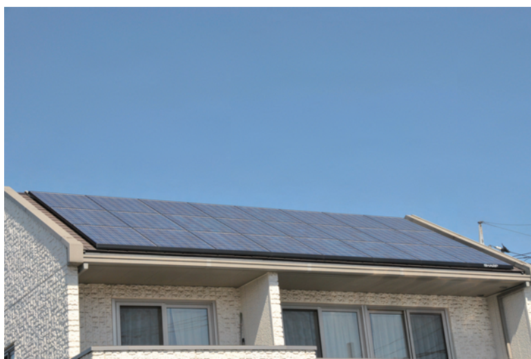
太陽光発電システム
