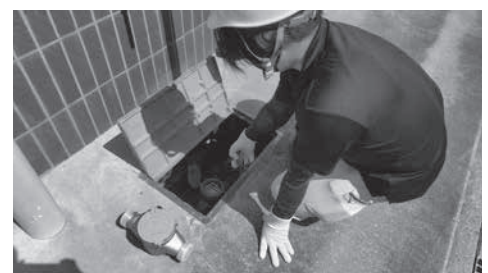
(参考) メーター交換の様子
