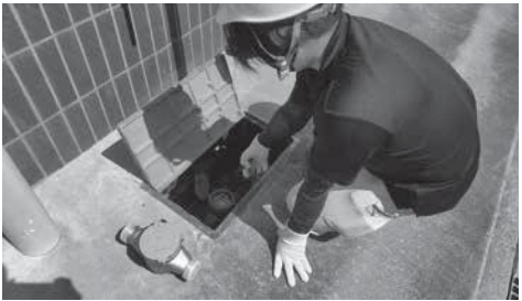
(参考) メーター交換の様子
