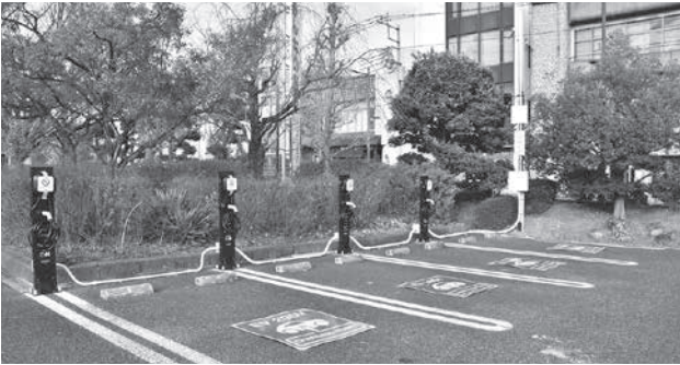
市役所に設置された電気自動車(EV) 普通充電器
