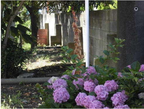
控え壁の間隔が広い(高さ1.2m超)
