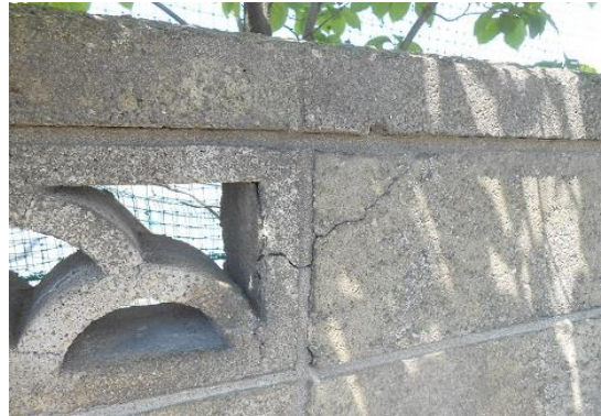
亀裂が入っている
